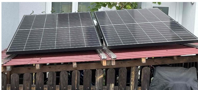
Bild: Solarstromproduktion auf Dach eines Fahrradständers in Roßdorf, Foto: W. Genthner, REG.eV
